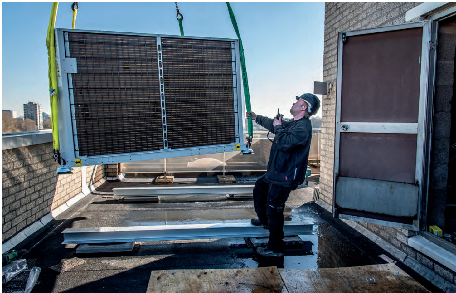
Veel appartementencomplexen met een centraal ketelhuis kunnen met warmtepomptechniek verduurzaamd worden.
