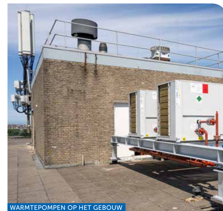
WARMTEPOMPEN OP HET GEBOUW
